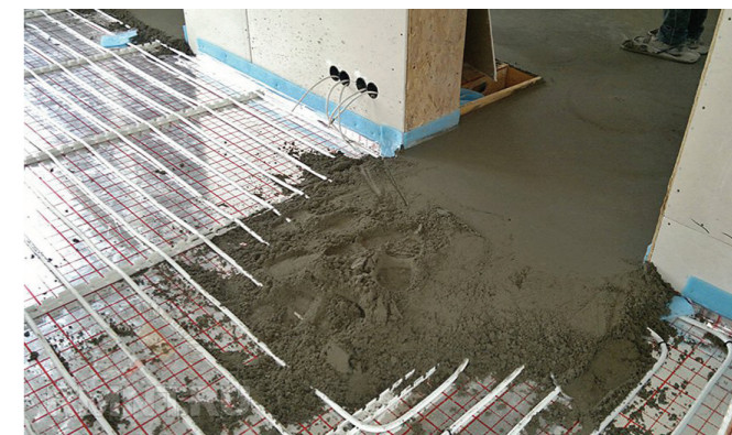
Рис. 6. Примеры конструкции плавающего теплого пола с применением материала «ТИЛИТ Супер ТП» и «Демпферной ленты ТИЛИТ»
